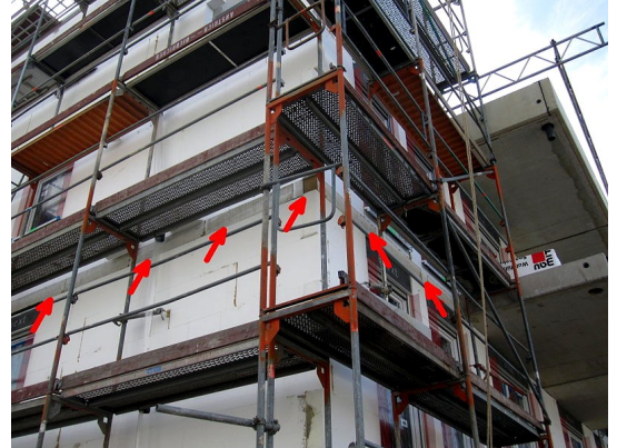
Brandschutzstreifen aus nicht brennbarer Mineralwolle in der Dämmung einer Hausfassade
